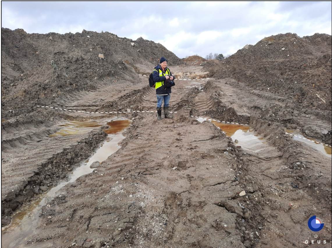
Figur 4. Eksempler på sprækker i den deponerede jord i området nord for jordskredet. Geologen i billedet står ved en større sprække, der forskyder hjulsporene, hvilket viser, at der både har været bevægelse ned og til siden. Mindre sprækker ses mange steder, og en anden større sprække ses lidt længere væk. De to største sprækker er markeret med stiplede hvide linjer. Billedet er taget i retning mod nord.
